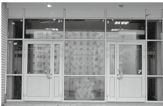
Рис. 2. Пример защитного ограждения, установленного с нарушением требований ГОСТ Р 57278-2016
