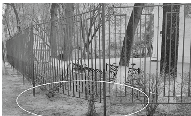
Рис. 1. Пример защитного ограждения, установленного с нарушением требований ГОСТ Р 57278-2016
